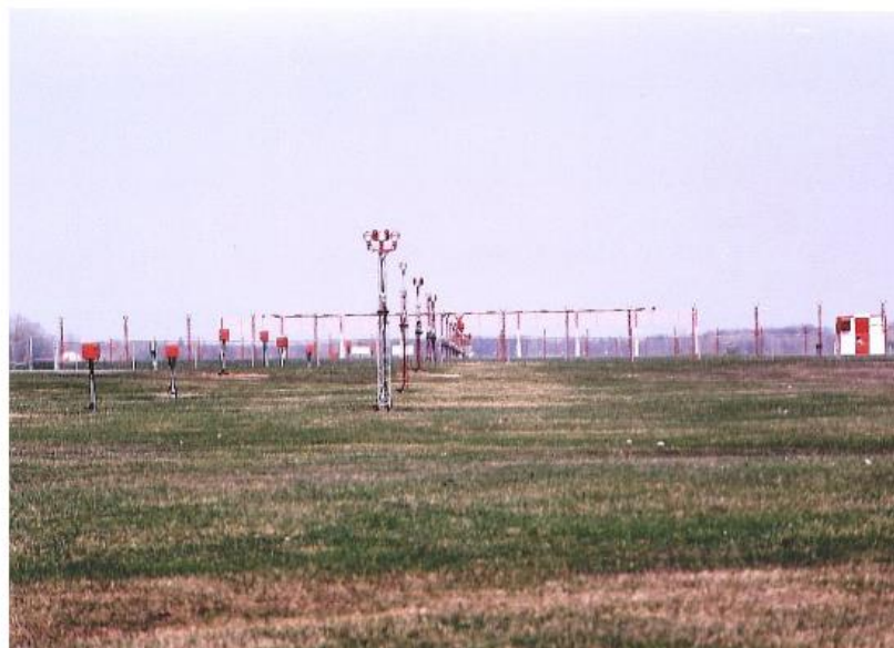
Рис. 4-4. Опоры огней приближения – алюминиевые решетчатые конструкции
