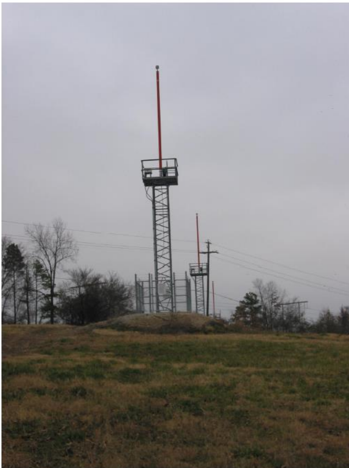
Рис. 4-7. Стеклопластиковый трубчатый столб на жесткой опоре
