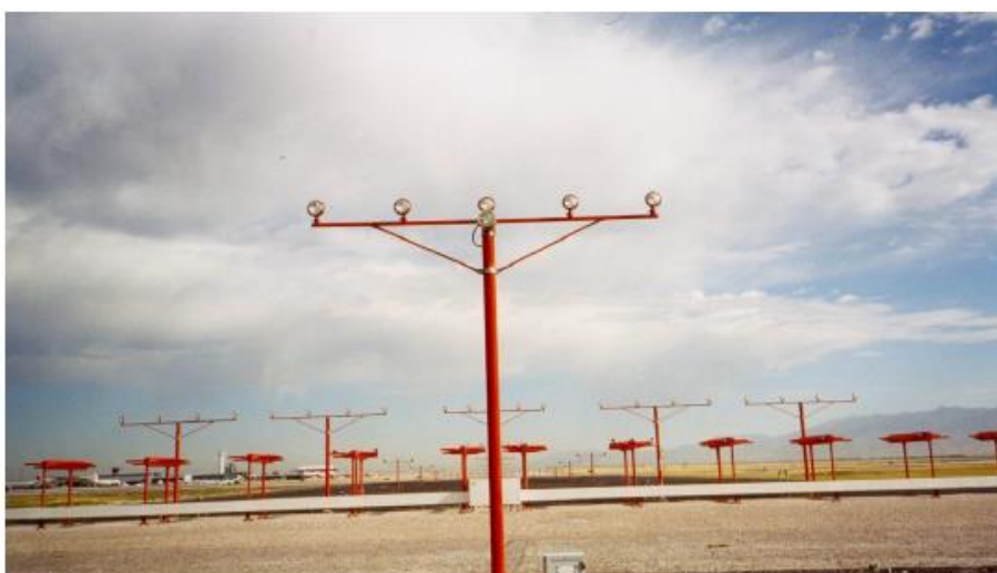
Рис. 4-3. Опоры огней приближения – стеклопластиковые трубчатые столбы
